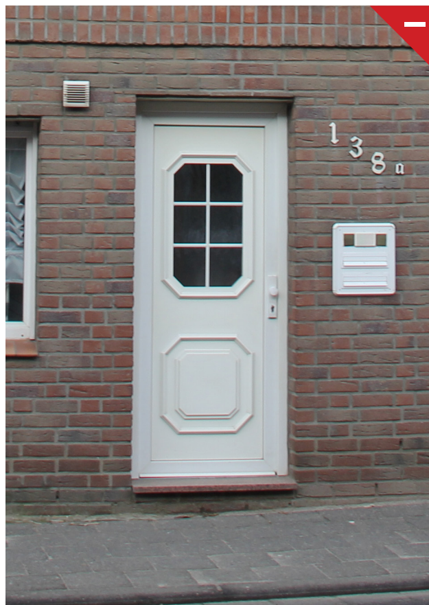
Abbildung 62: Günstige, nicht auf die Fassade abgestimmte, standardisierte Baumarktplastiktür.
