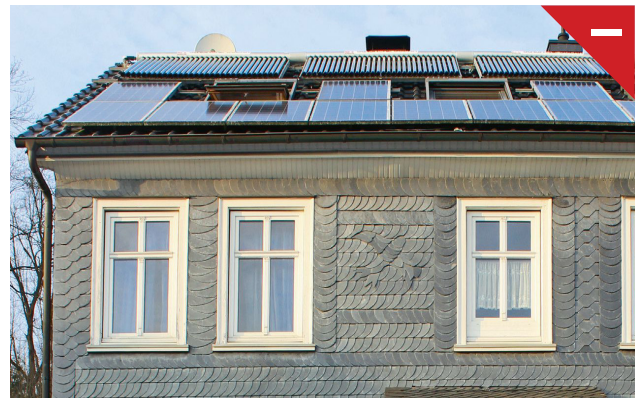
Abbildung 40: Mehrere Solaranlagen in wilder Kombination stören das Dachbild.
