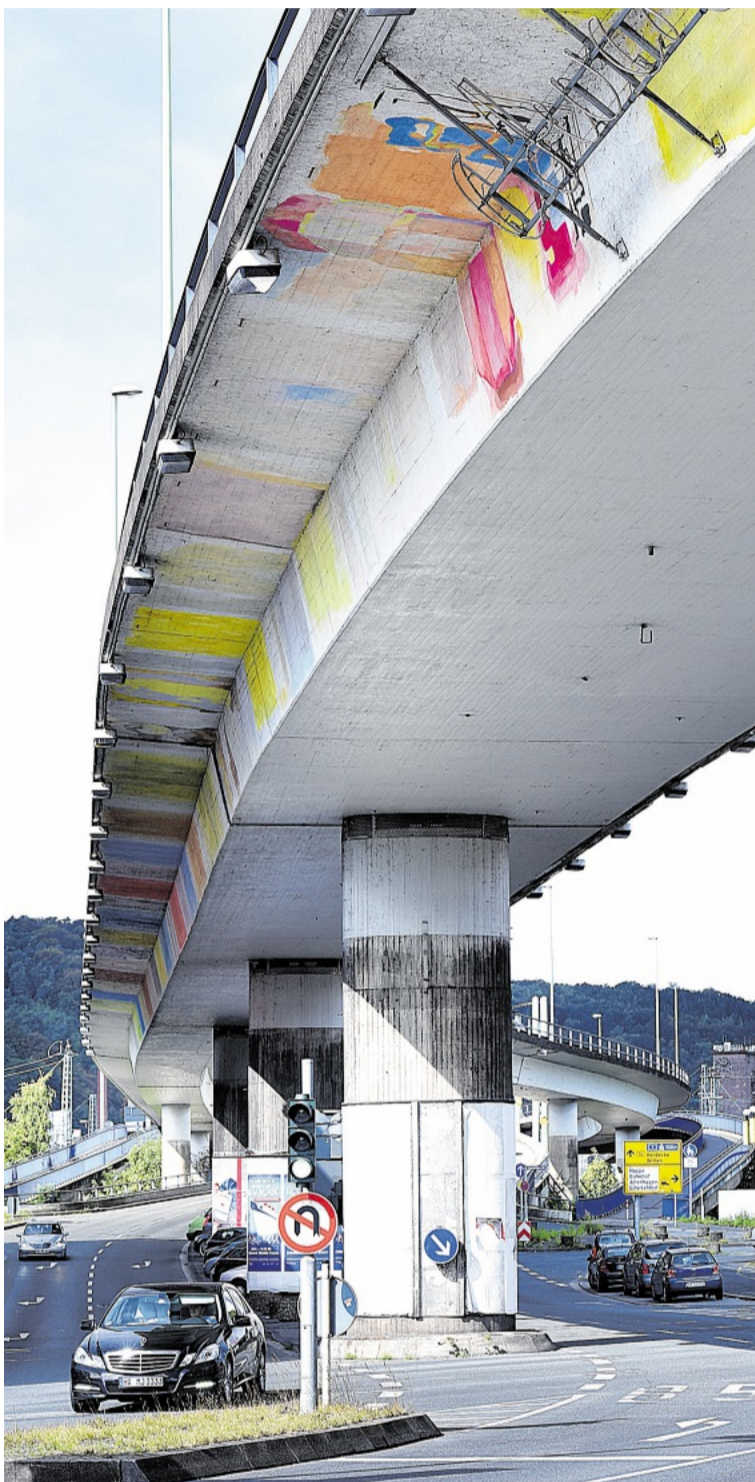
Der Abriss der „Ebene 2“ in Altenhagen rückt in greifbare Nähe. Eine Sanierung des maroden Bauwerks scheint nicht mehr sinnvoll. FOTO: MICHAEL KLEINRENSING
