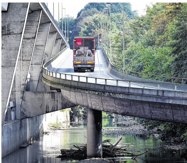
Die Rampe hinter dem Arbeitsamt verdeckt nicht nur den Lauf der Volme, sondern droht auch ohne Vorankündigung ihre Traglast zu verlieren. FOTO: MICHAEL KLEINRENSING
