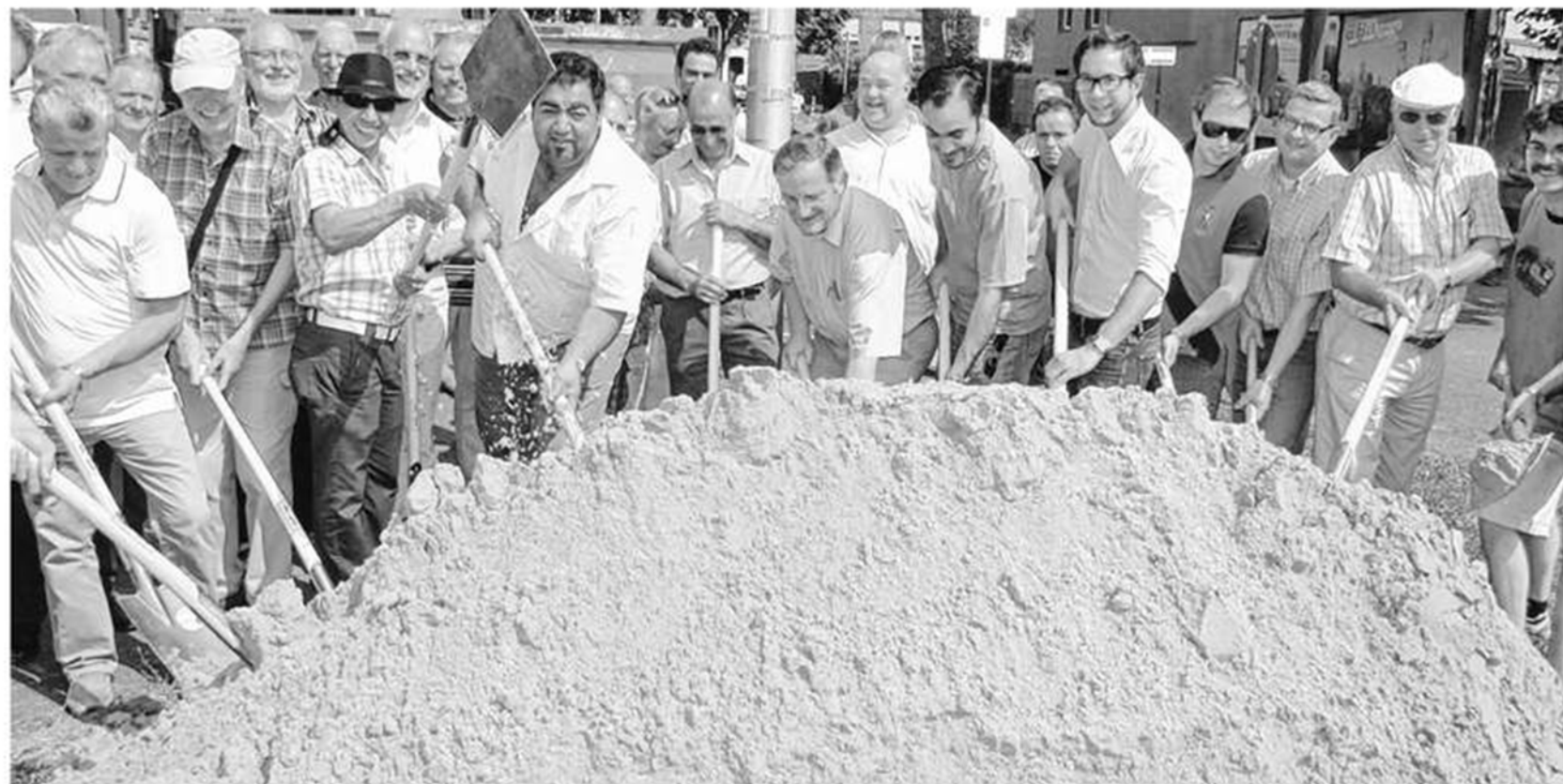
Erster Spatenstich für die Neugestaltung der Eintrittspforte von Nord-Düren: Die Mitglieder der Projektgruppe „Gestaltung Eingangsbereich Kerngebiet“ griffen mit Bürgermeister Paul Larue zu den Spaten. Foto: Schröder
