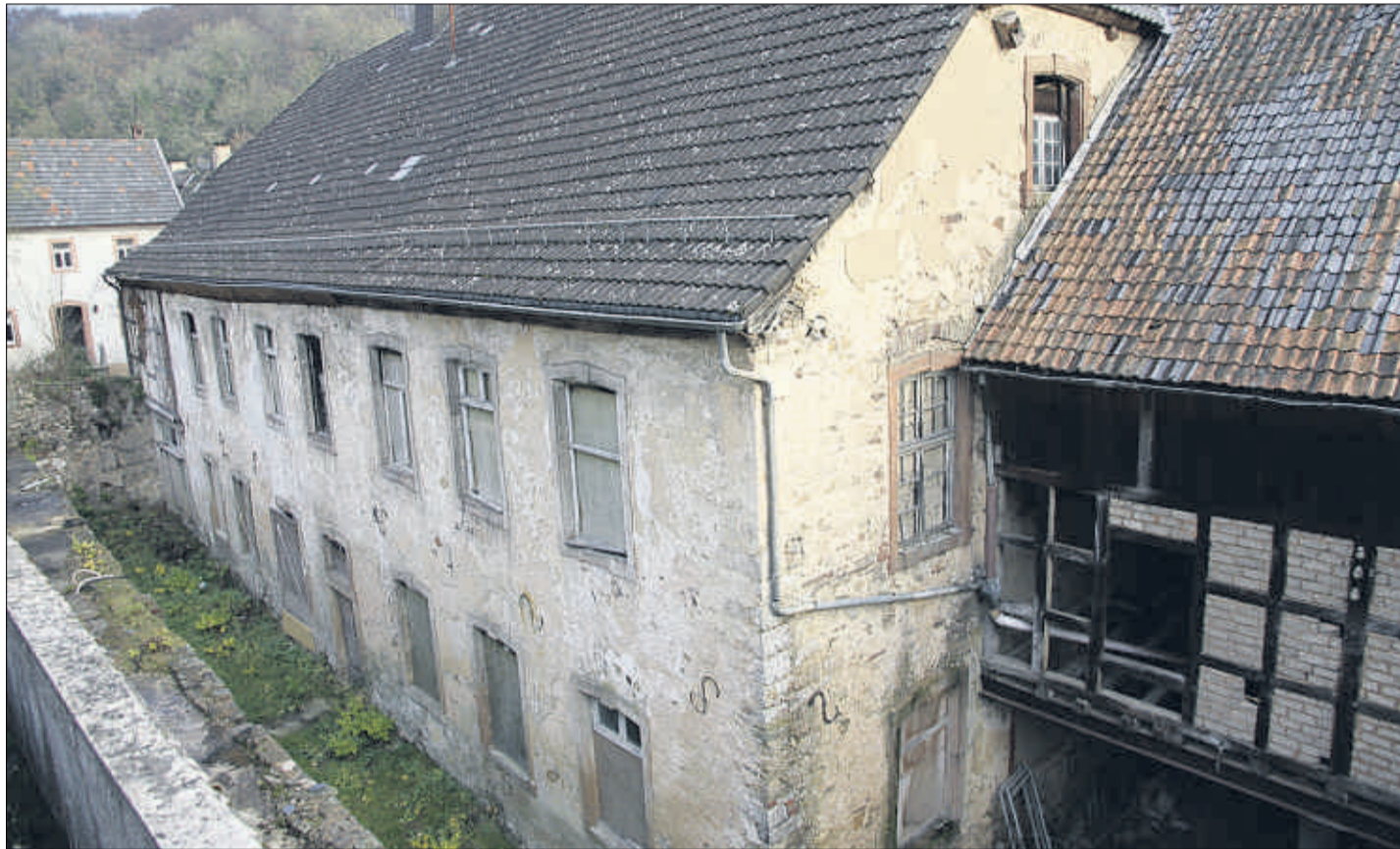
Der Konsum verfällt seit Jahren, er ist ein Schandfleck in Blankenheim. Nun soll er zum Rathaus umgebaut werden. (Fotos: Puderbach)
